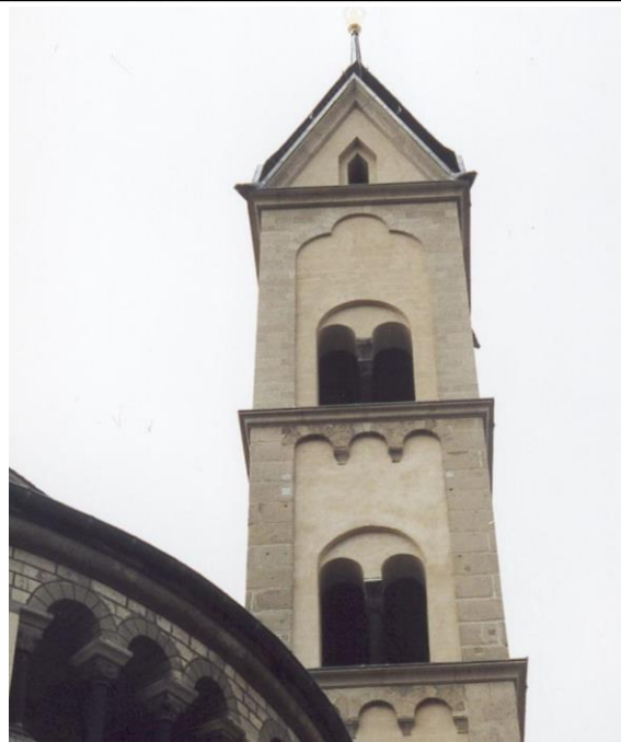
Koblenz, St. Kastor, nördlicher Chorflankenturm aus dem 12. Jahrhundert. Im Jahr 2000 wurden die oberen beiden Geschosse aus statischen Gründen neu aufgebaut. Im Zuge der Maßnahmen war die Entnahme von Mörtelproben möglich. Das Foto zeigt den Zustand im Jahr 2002.
