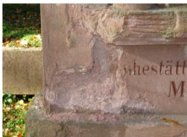
Absanden/Abbröckeln und Salzausblühungen
