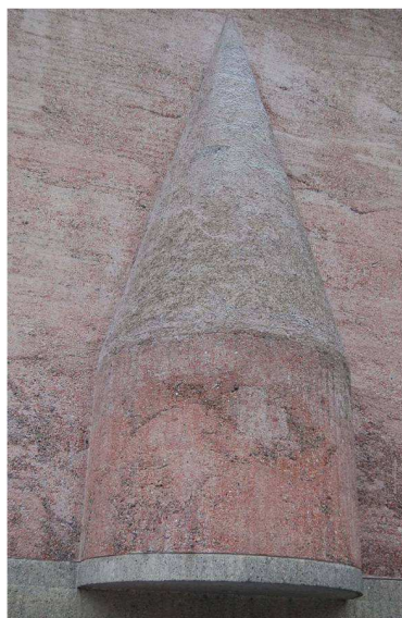
Der an den Ziegelsplittbeton angepasste Instandsetzungsmörtel erscheint nach fünf Jahren deutlich grauer.
