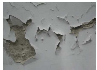
Schlangenbad, Kurkolonnaden, Putzschädigung unter dichter Beschichtung
