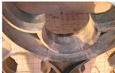
Der gleiche Vierpass nach Durch- führung der Reparatur- maßnahmen.
