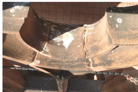
Einer der Vierpässe des Maßwerkgie- bels. Ange- troffener Zustand.
