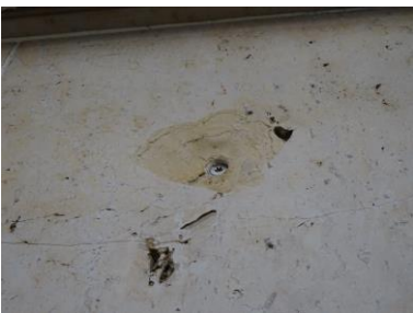
Kaiserslautern, Kreisverwaltung, Schaden durch Nachverdübelung von Fassadenplatten
