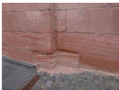
Bad Camberg, kath. Kirche; Sandsteinverwitterung durch Feuchte- und Salzbelastungen
