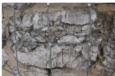
Bad Frankenhausen, Hausmannsturm, Verwitterung von Gipsstein
